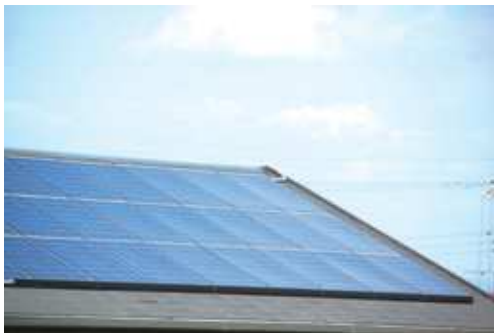
図4.太陽光パネル
